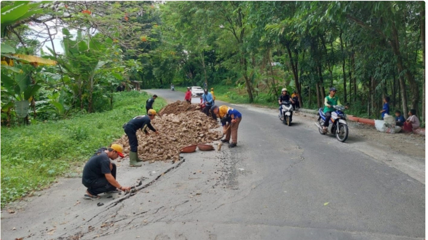
Polres Sukabumi Inisiasi Perbaiki Jalan Yang Rusak Dengan Instansi Terkait Jelang Nataru
